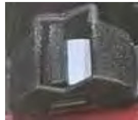
weißes Feld: Drehrichtung falsch: Strömung im Temperierkreislauf zu niedrig
